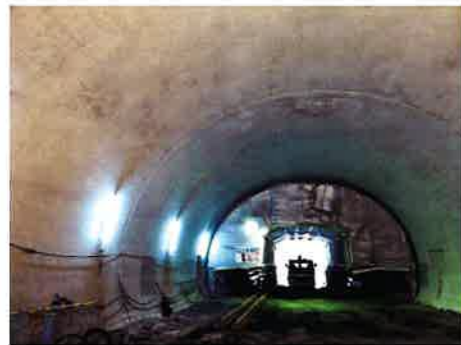
国土交通省東北地方整備局発注 国道 45 号線釜石山田道路八雲 第一トンネル (二次覆工の一部)
